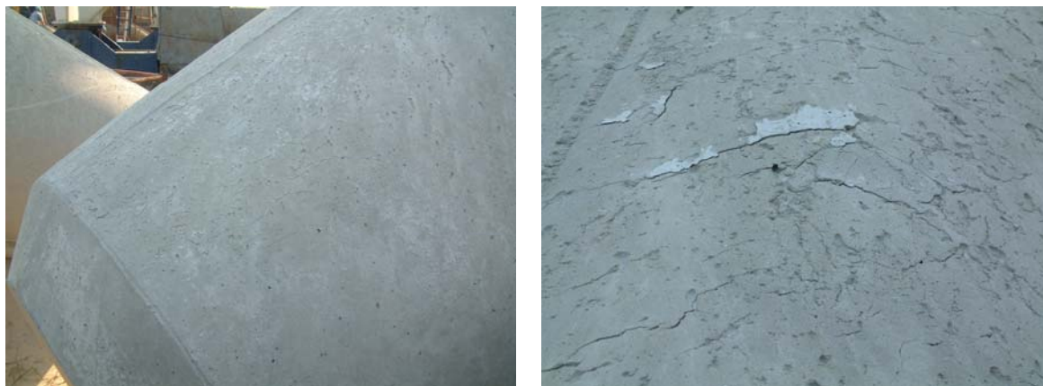
Figura 5.3 – Fendilhação superficial observável após remoção da cofragem
