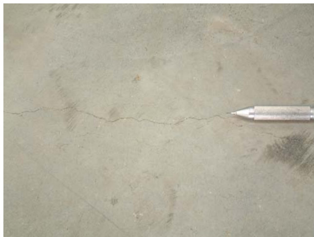
Figura 5.77 – Fendilhação observada em obra
