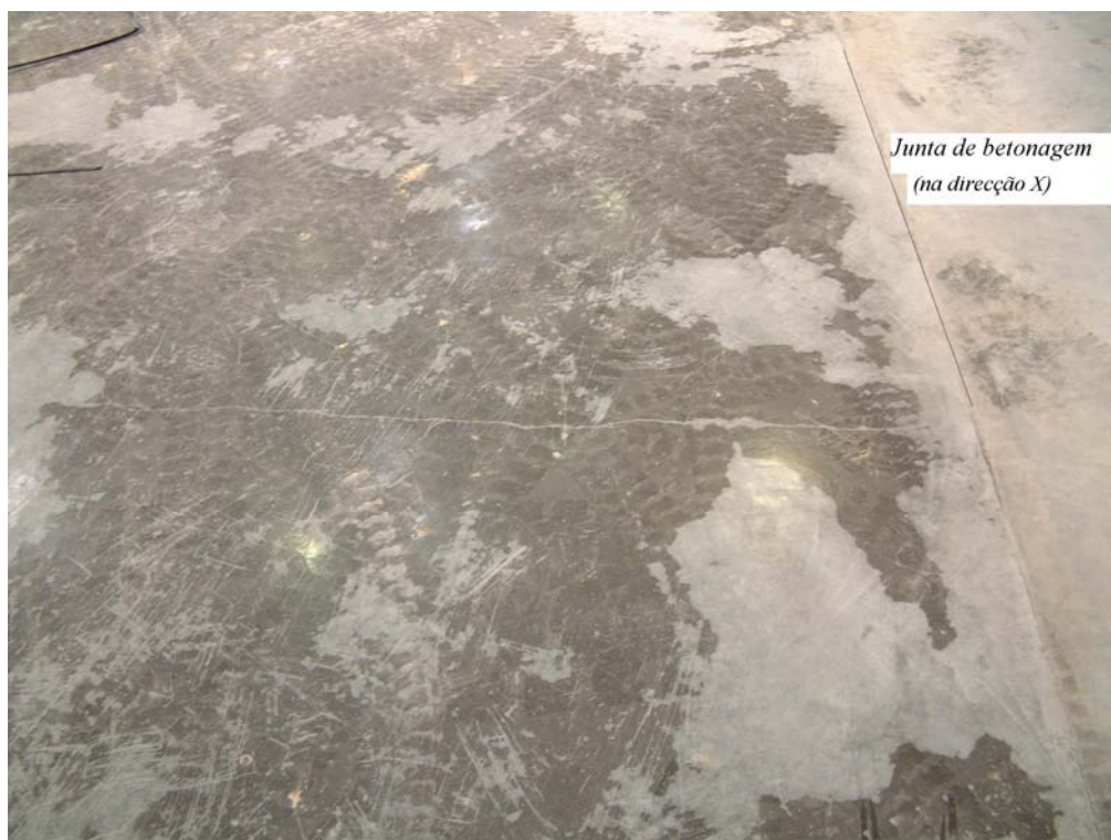
Figura 5.78 – Fendilhação observada em obra
