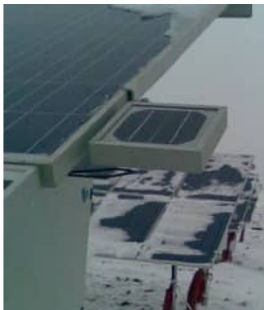
Figura 21 - Célula solar de referência instalada junto de um painel solar.
