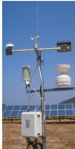
Figura 20 - Estação meteorológica típica de uma central fotovoltaica.
