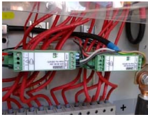
Figura 23 - Controladores de string .
