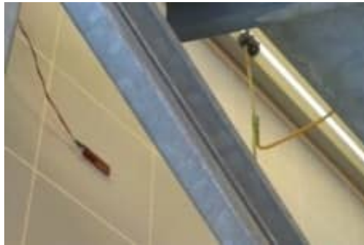
Figura 22 - Sensor de temperatura (à esquerda) instalado na parte de trás de um módulo fotovoltaico.
