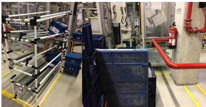
Figura 31 - Estante desajustada ao tipo de caixas e margem de segurança para o extintor não respeitada
