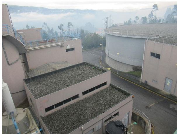
Figura 30 – ETA de Castelo de Paiva.
