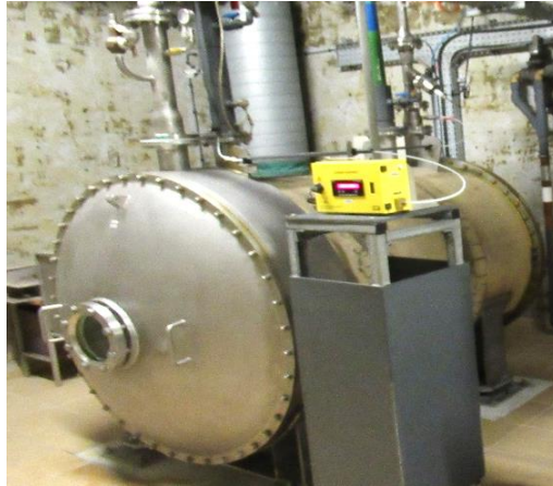
Figura 23 – Ozonizador da ETA de Lever, à entrada.
