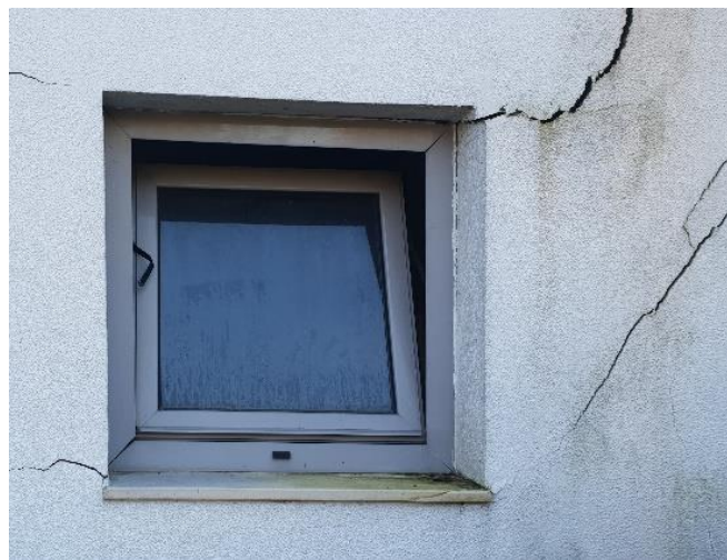
Figura 34 – Fissuras na ETA do Ferro.
