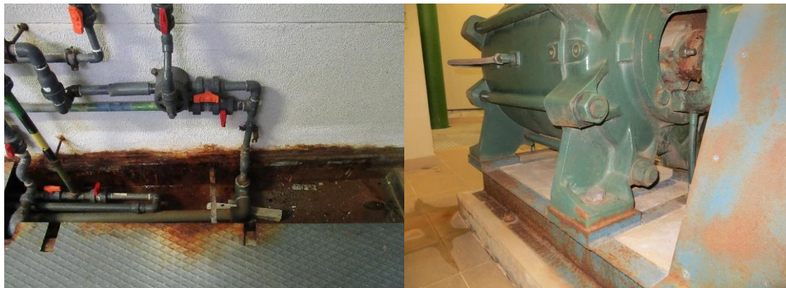
Figura 36 – Corrosão na ETA de Castelo de Paiva (à esquerda) e na ETA do Ferro (à direita).
