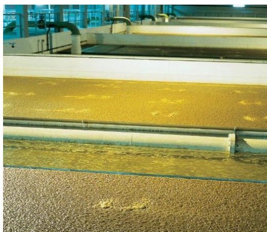
Figura 22 – Filtros da ETA de Lever.
