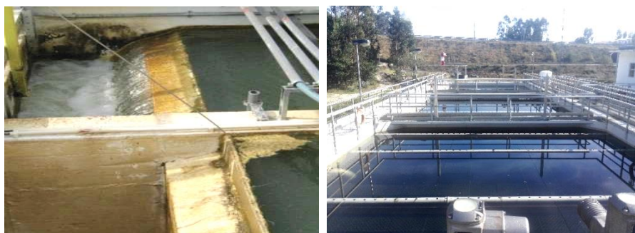
Figura 20 – Coagulação (à esquerda) e floculação (à direita) da ETA de Castelo de Paiva.
