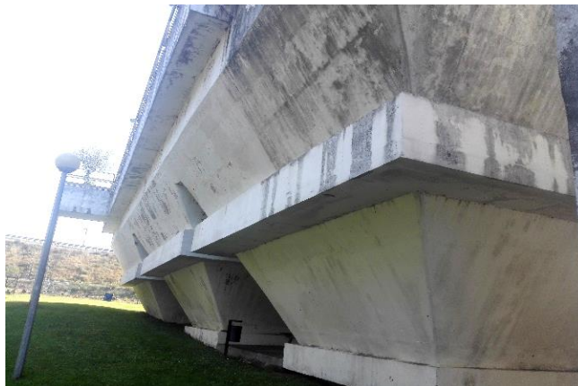
Figura 21 – Decantadores da ETA do Ferreira.
