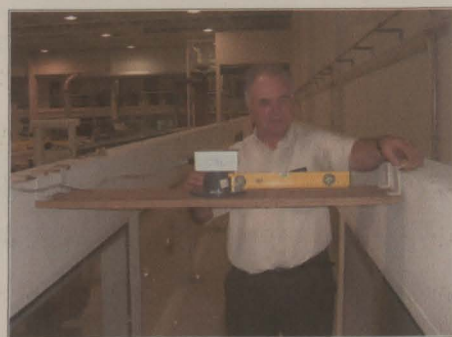
Fotografia A.10 Montagem do Sensor do medidor de nível
