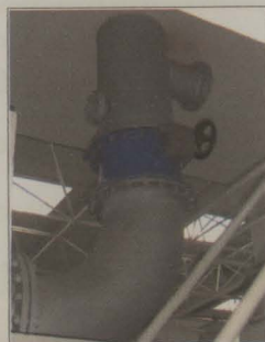
Fotografia A.1 - Válvula na conduta de alimentação do canal
