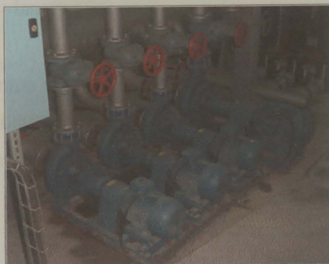
Fotografia 5.1 - Aspecto geral das bombas
