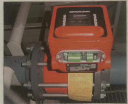
Fotografia 5.4 Pormenor da zona de alimentação eléctrica do medidor de caudal
