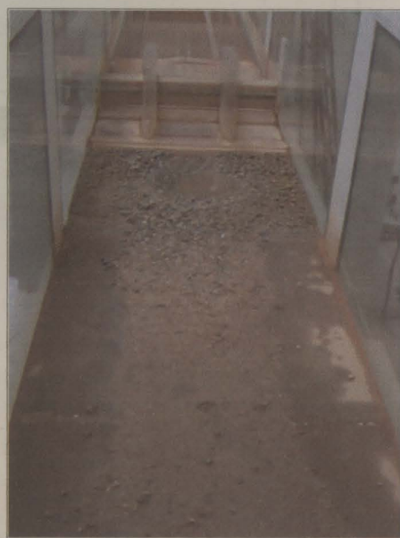
Fotografia 7.5 - Fossa de erosão final (Vista do interior do canal)
