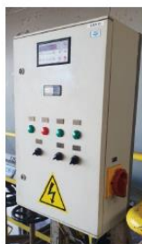
1. Figura 2 – Quadro Elétrico
