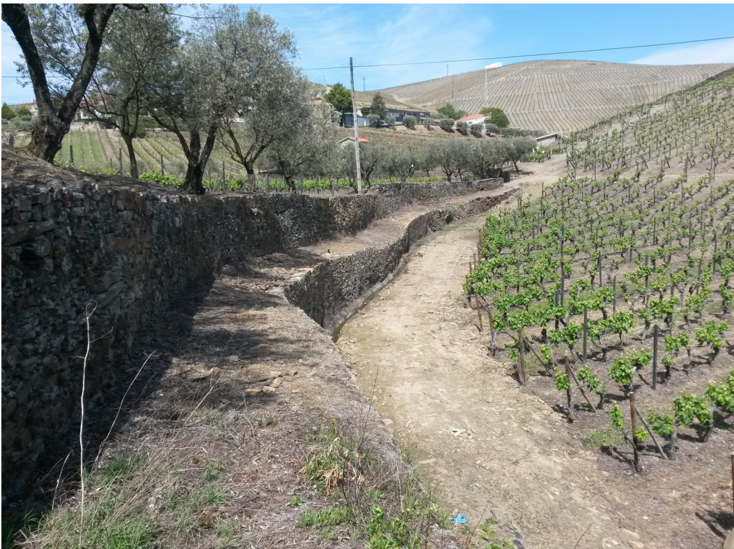
Fotografia do muro com os orifícios para pilheiros na Quinta Seara D'Ordens.
