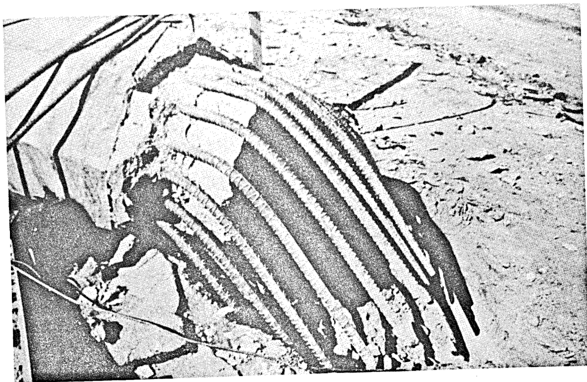
Fig. 1.15 - Arrancamento de um pilar do seu elemento de fundação (Ref. 1).
