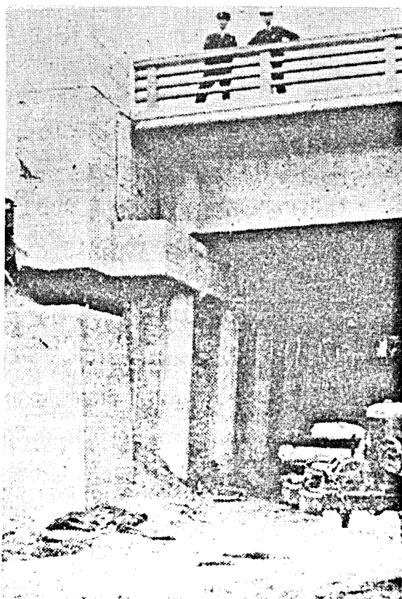
Fig. 1.10 - Ponte de Showa. Aspecto dos danos no encontro da margem esquerda (Ref. 1).
