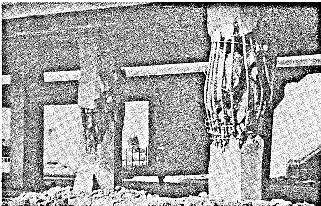
Fig. 1.21 - Danos devidos ao esforço transversal nos pilares de um viaduto sobre a auto-estrada nº 210 (Ref.1).
