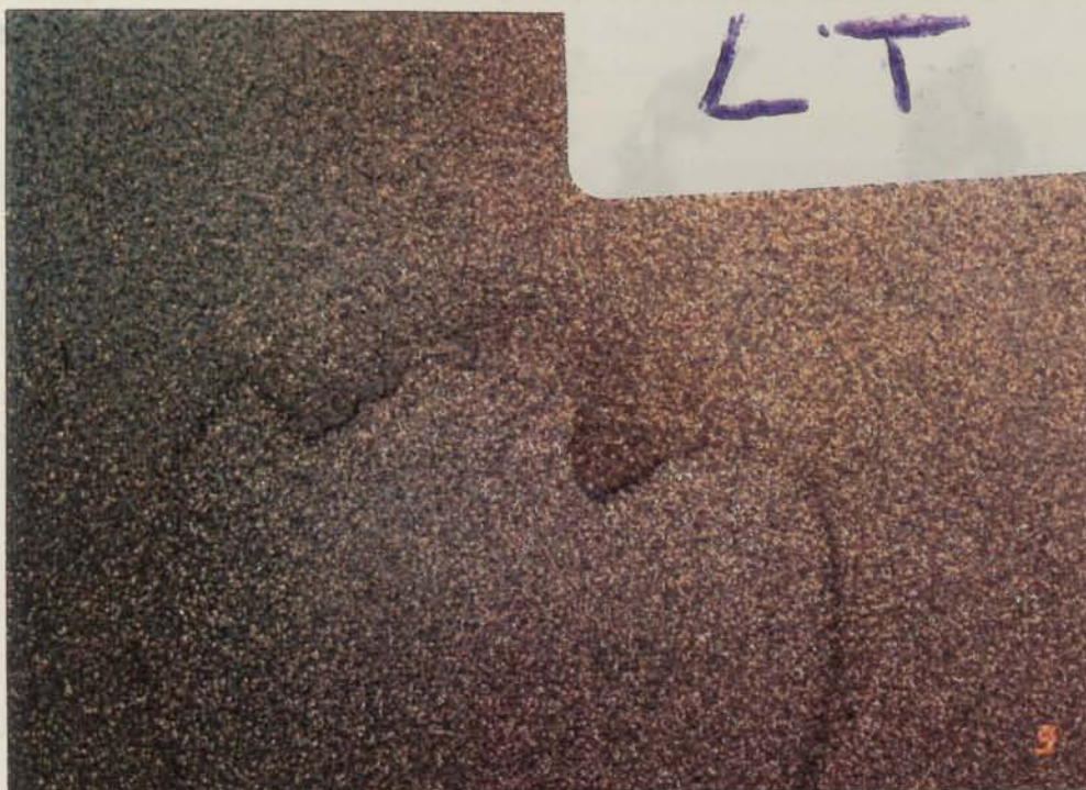
a) Vista do lado onde foi feita a projecção. Há um ligeiro destacamento do revestimento.
