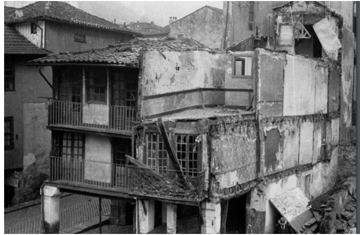
Figura 416 - Porto: demolições na rua de Miragaia. 1941. Fotografia de Bomfim Barreiros. AHMP. http://gisaweb.cm-porto.pt/units-of-description/documents/714670/
