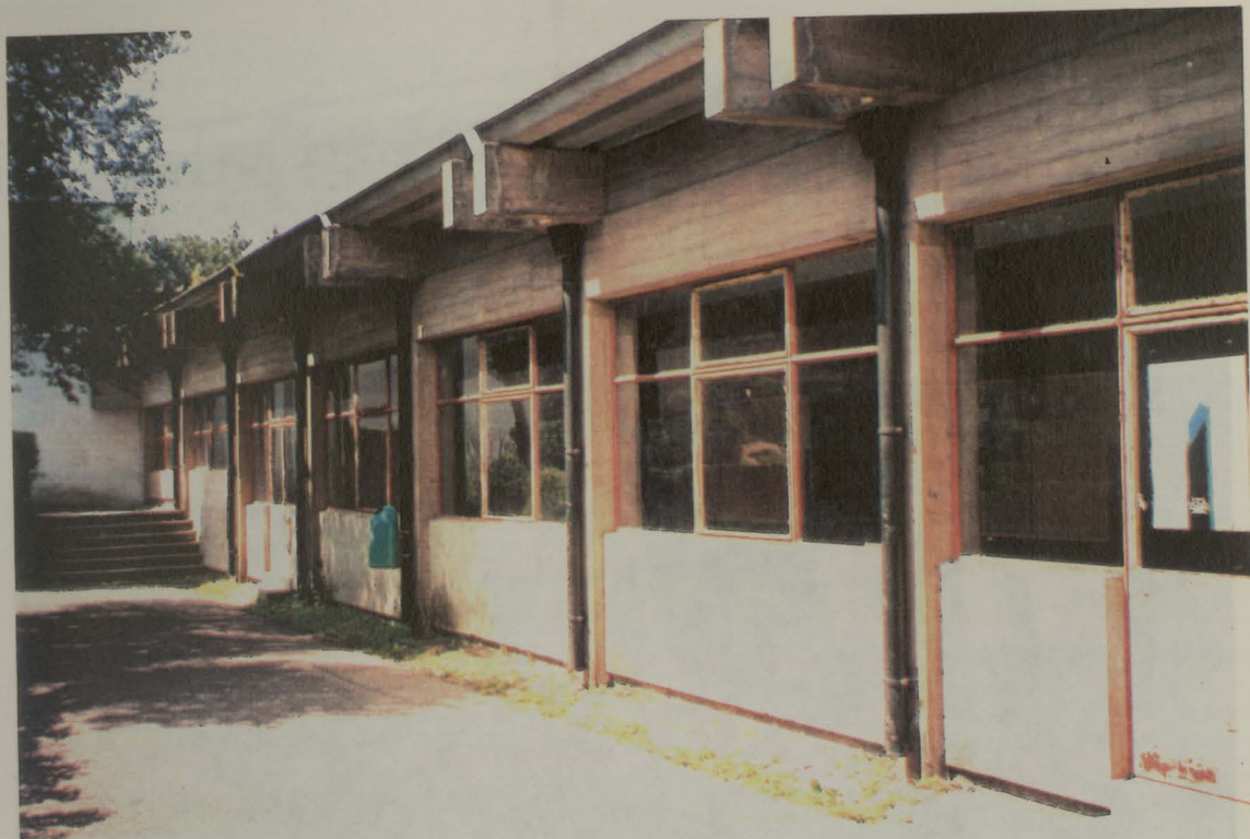
Fig. 3.3- Fachada do Liceu Garcia da Horta. Superfície de betão à vista obtida com cofragem de madeira, constituída por tábuas aparelhadas
