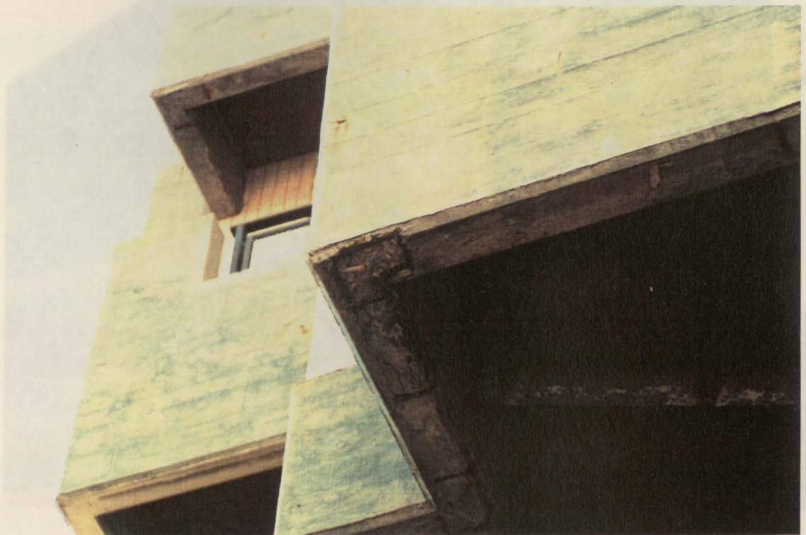
Fig. 5.6- Armadura à vista devido ao pequeno recobrimento de betão que existia
