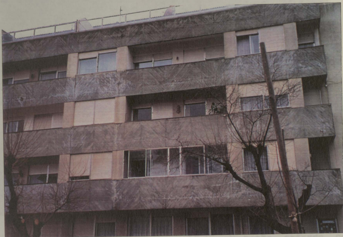
Fig. 3.5- Aspecto visual de um paramento de betão dado pelo jogo de uma cofragem de madeira
