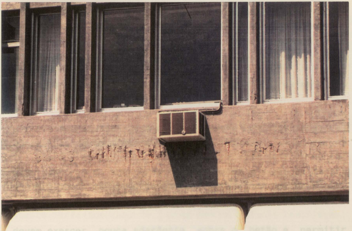
Fig. 4.24- Fachada de um edifício com armadura à vista em estado de corrosão
