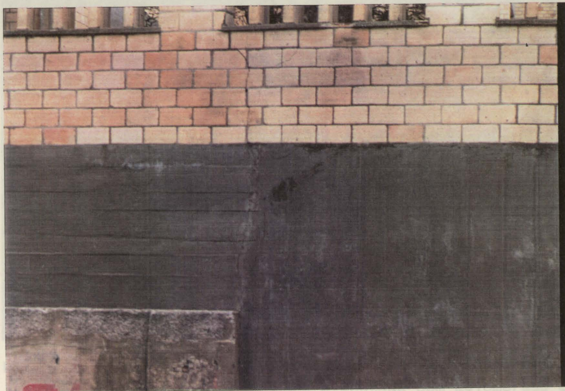
Fig. 4.13- Fachada de um edifício com uma fissura de origem estrutural
