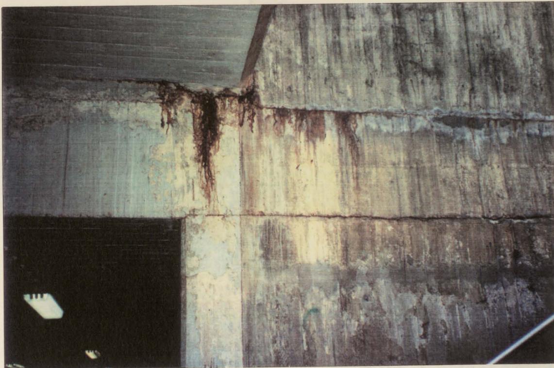
Fig. 4.15- Superfície muito manchada, principalmente devido a uma junta de obra executada com aglomerado de cortiça e a uma reparação de superfície mal conseguida
