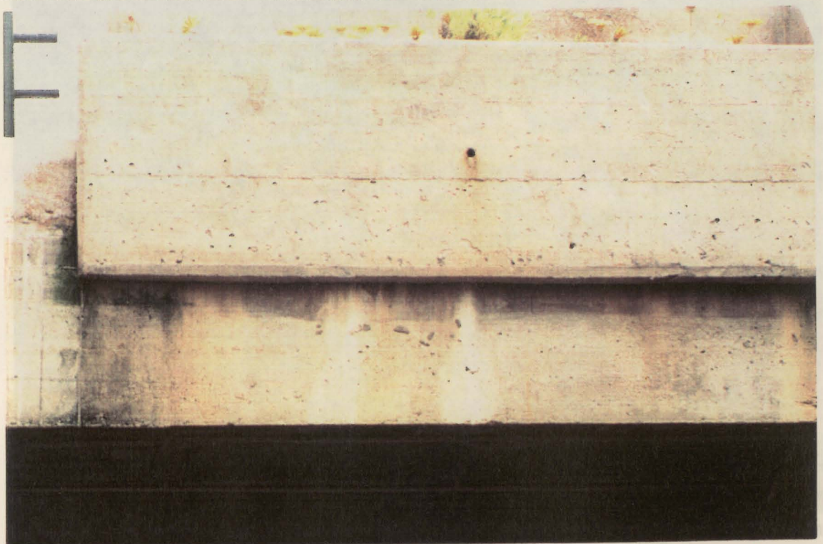
Fig. 4.4- Superfície de betão dominada pelas bolhas de ar
