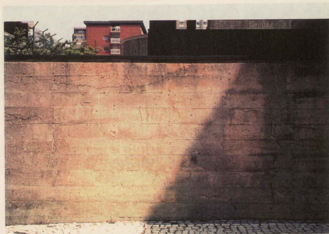
Fig. 4.14- Superfície de betão bastante fissurada
