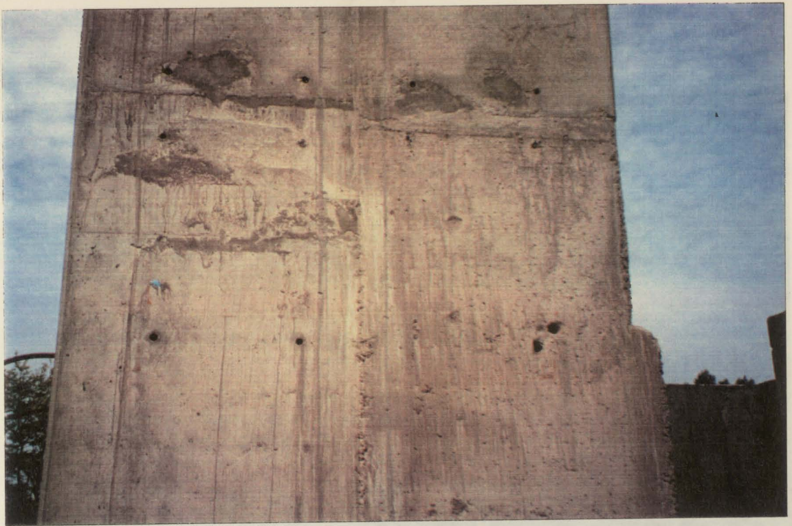
Fig. 4.7- Superfície de betão destinada a ficar à vista, recém construída e ainda sem qualquer acabamento onde são visíveis bastantes vazios, além de outros defeitos, nomeadamente crostas
