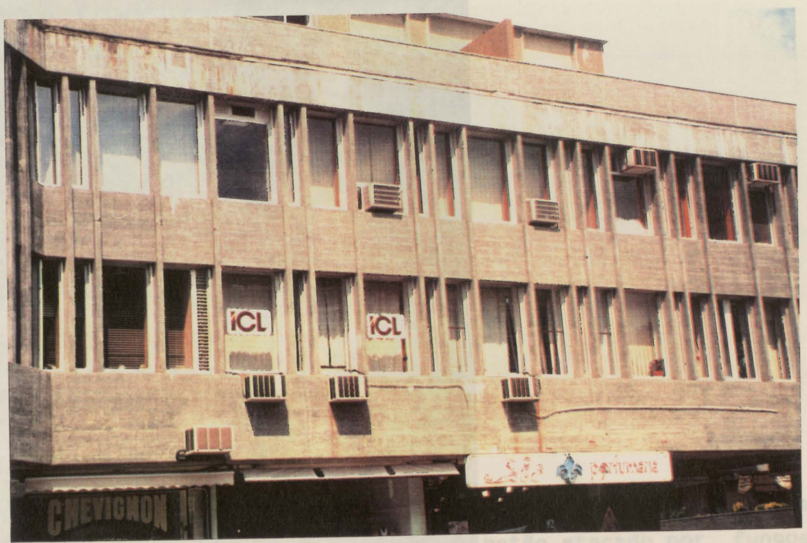
Fig. 4.20- Superfície em que além de outras manchas é dominada por eflorescências
