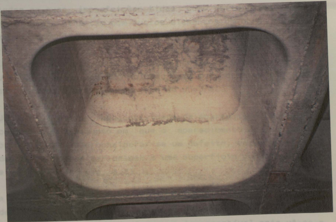
Fig. 3.12- Pormenor de um alvéolo da estrutura da figura anterior em que se verifica a qualidade do acabamento que esta cofragem permite
