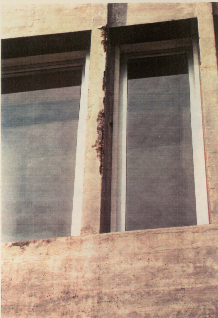
Fig. 5.5- Deteoração do betão colocando a armadura à vista
