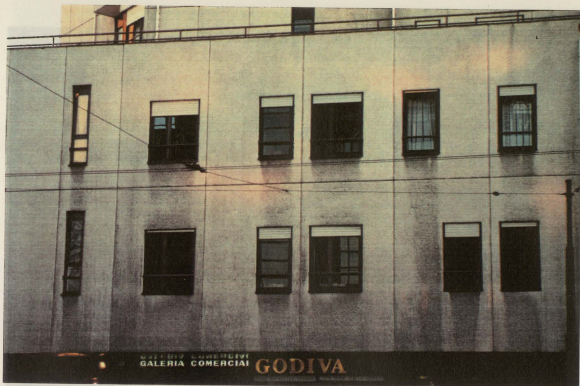
Fig. 9.3- Betão com sujidades transferidas de outros elementos de obra
