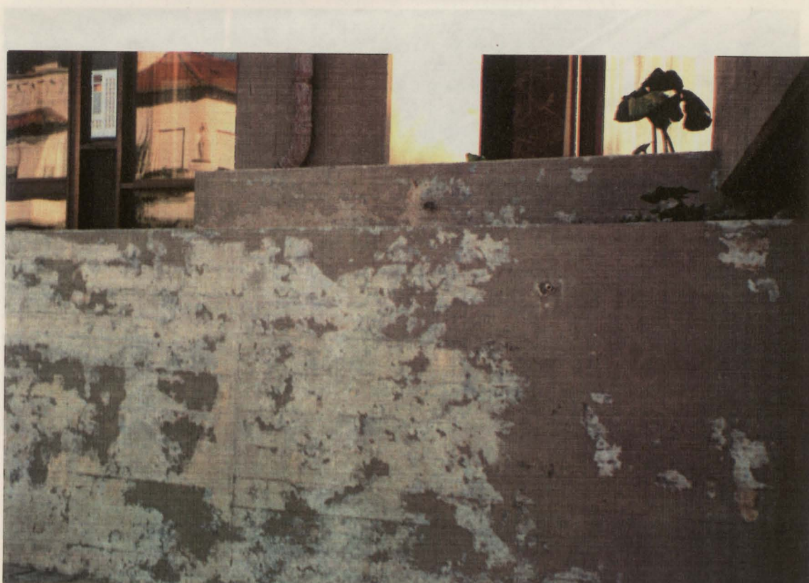
Fig. 9.8- Pintura do betão destruída com o tempo
