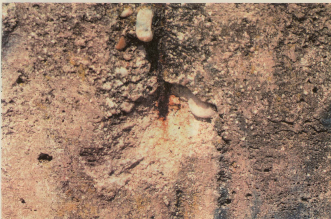
Fig. 5.7- Pormenor de um descasque que provocou o aparecimento da armadura ao ar e a sua corrosão
