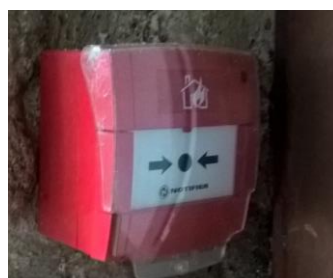
Fig.2 – Sistema de alarme
