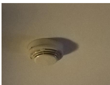
Fig.1 – Sistema de deteção de fumo
