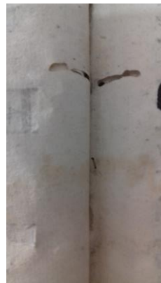
Fig. 185 - Galerias provocadas pela atividade, extinta, de insetos
