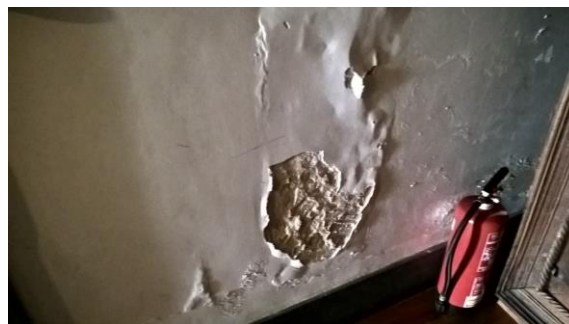
Fig.6 – Parede do 1º Piso
