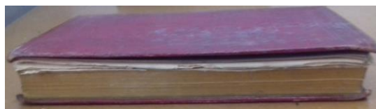
Fig.226 - Destacamento de fólhos e cadernos relativamente à encadernação. Livro não fecha totalmente devido à absorção de humidade
