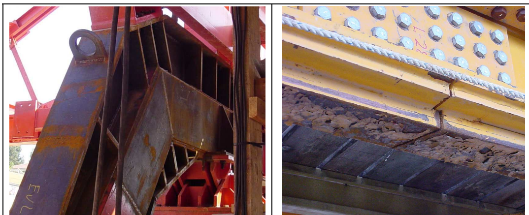
Figura II.31 – Oxidação superficial - elemento sem protecção (à esquerda) ; “descamação” da tinta de revestimento (à direita)
