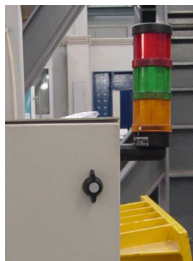
Figura IV.48 – Torre de luzes instalada no quadro de comando
