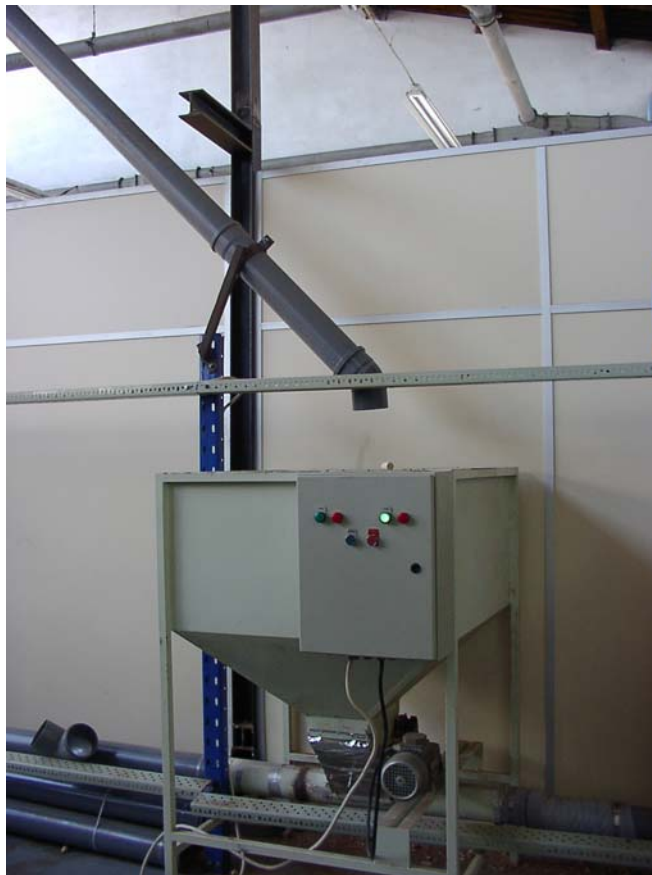
Figura 2.6 - Tremonha de alimentação de sólidos à conduta.
