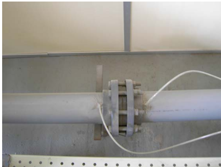
Figura 2.5- Pormenor da placa orifício para medição indirecta do caudal de fluido transportador.
