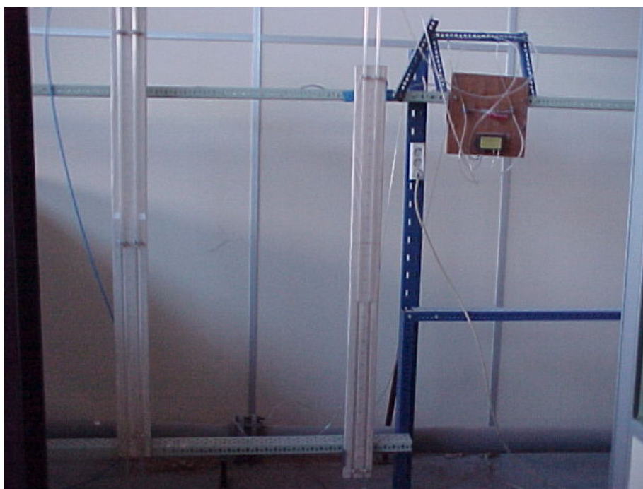
Figura 2.4- Zona da tubagem horizontal onde está instalado o medidor de caudal de diafragma.
