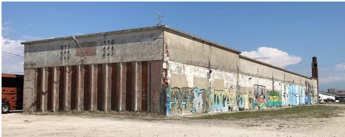
Fig. 75 | Cobertura da Plataforma de carga e descarga desaparecida.
