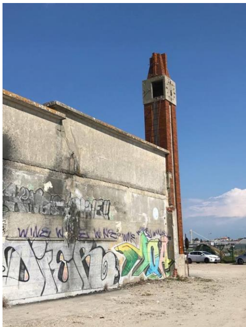
Fig. 77 | Degradação da torre do relógio.
