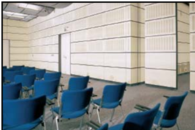
Fig.4-6- Painéis acústicos Nusing como acabamento da parede [26]
