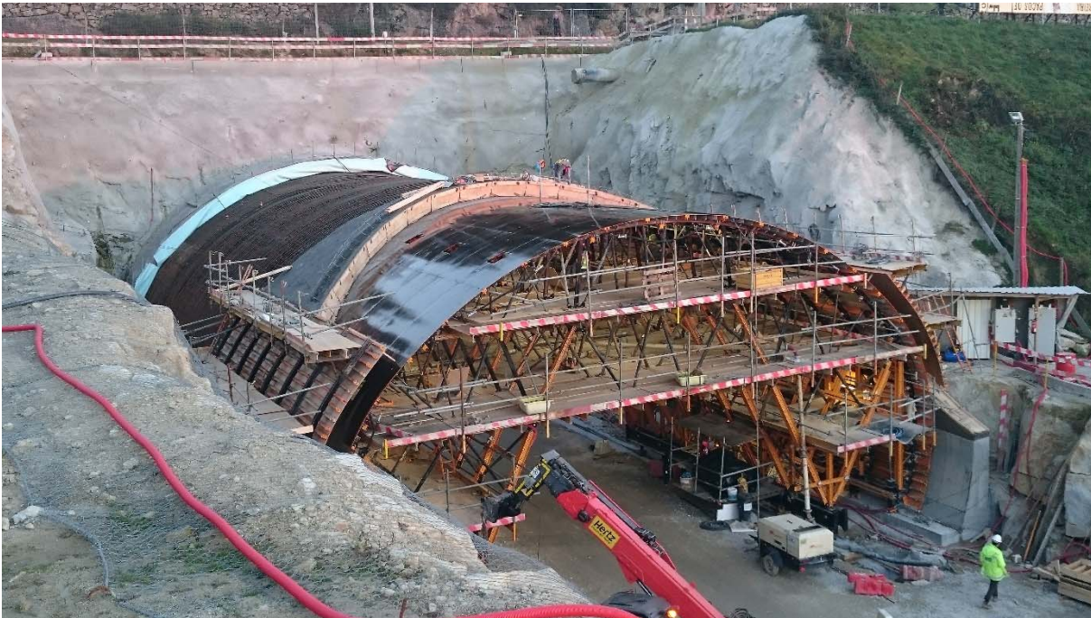
Fig. 126 – Carro de cofragem (TAS)
