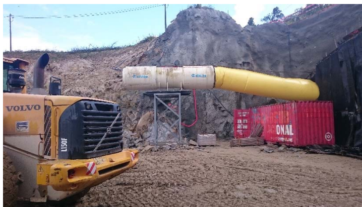
Fig. 70 – Ventilador no túnel de Águas Santas
