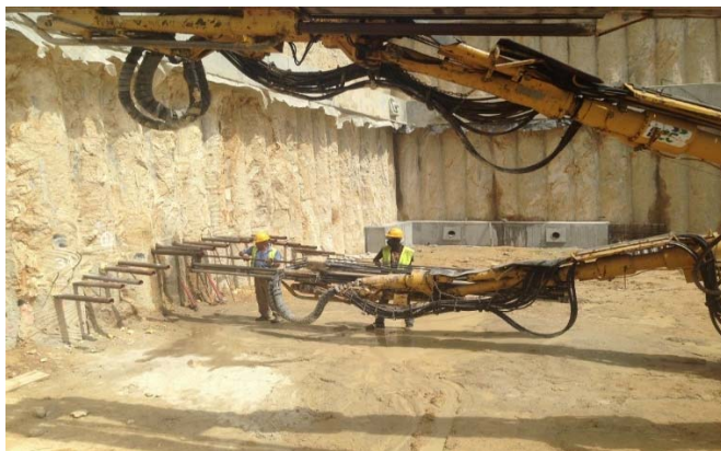
Fig. 81 – Furação para instalação de pregagem de frente de fibra de vidro (Félix, 2018)
