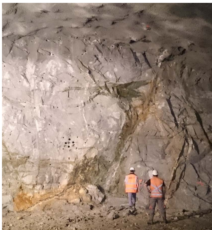
Fig. 52 – Caldeiro cilíndrico de 4 furos no túnel de Águas Santas
