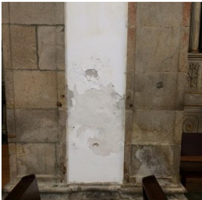
Fig. 5.18 – Manchas de humidade e salitre na parede 15 da Igreja de São Gonçalo
