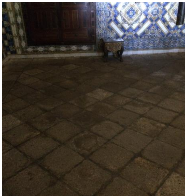
Fig. 5.23 – Manchas de humidade de intensidade frequente no pavimento da Sacristia da Igreja de São Gonçalo
