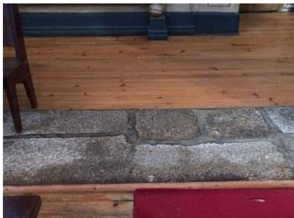
Fig. 5.7 – Manchas de Humidade no pavimento da Igreja de São Gonçalo
