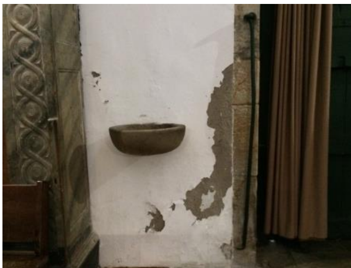
Fig. 5.10 – Manchas de Humidade com destacamento da pintura na parede 1 da Igreja de São Gonçalo
