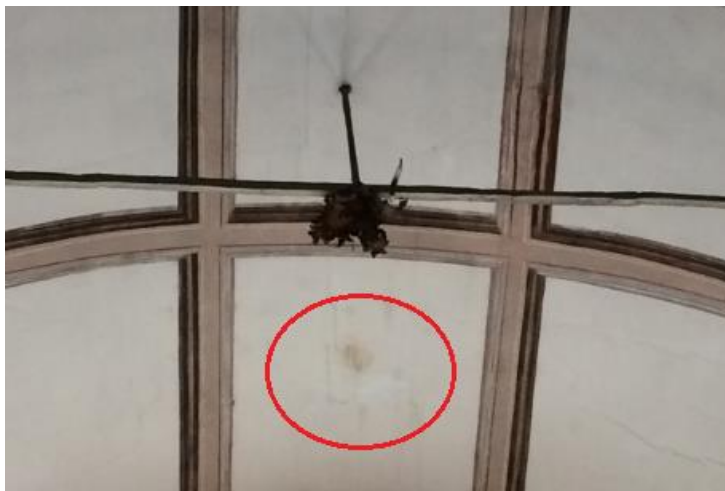
Fig. 5.9 – Mancha de humidade no teto da Igreja de São Gonçalo
