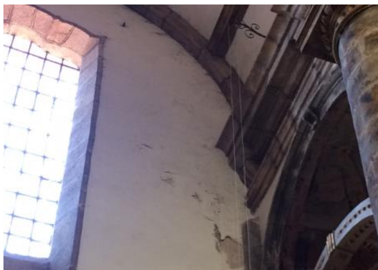
Fig. 5.14 – Manchas de humidade com destacamento da pintura na parede 3 da Igreja de São Gonçalo
