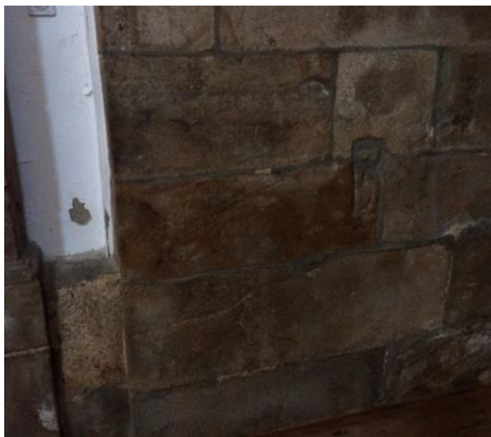
Fig. 5.12 – Manchas de humidade e salitre na parede 2 da Igreja de São Gonçalo
