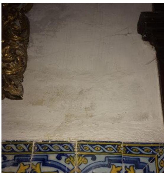
Fig. 5.25 – Mancha de humidade na parede 2 da Sacristia da Igreja de São Gonçalo
