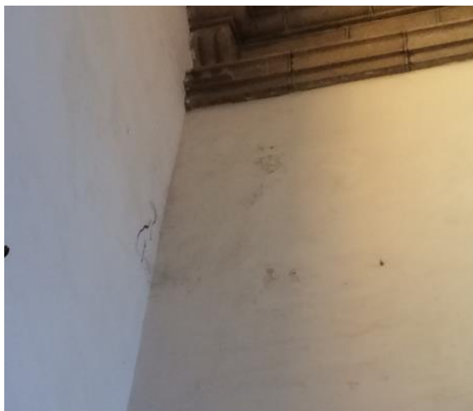
Fig. 5.16 – Manchas de humidade na parede 10 da Igreja de São Gonçalo
