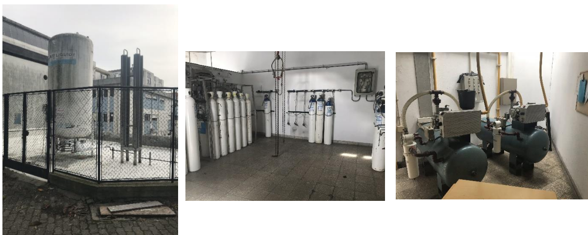
Fig. 6 – Reservatório criogénico de oxigénio, rampas de gases medicinais, produção de vácuo e ar comprimido.
