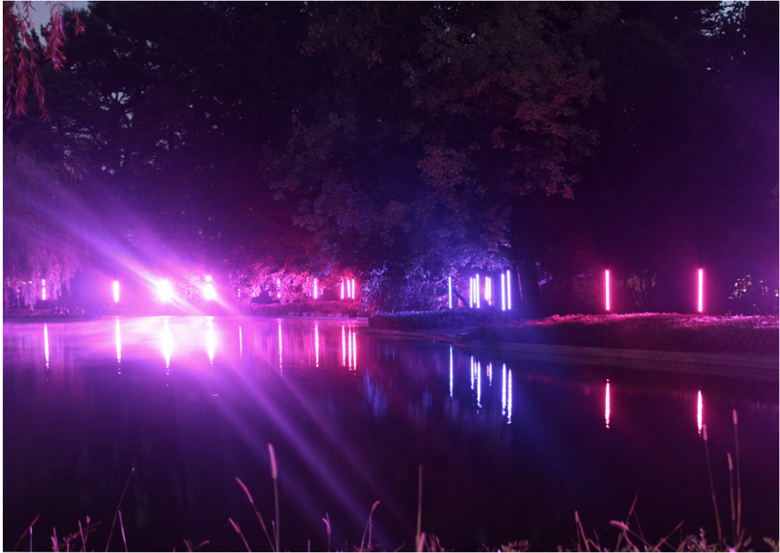
Figura 105: Vista da instalação
