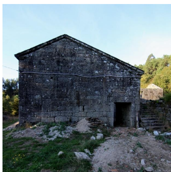
41. Casa em avançado estado de ruína, actualmente
