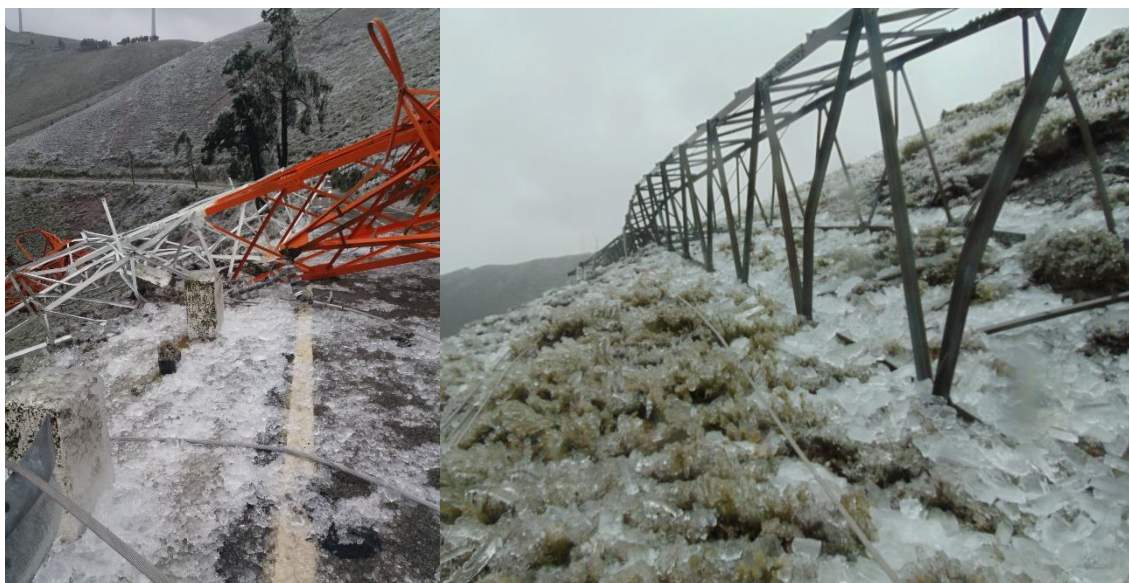
Figura 8.2 - Queda de apoios sob efeito do gelo, Guimarães, fevereiro 2018
