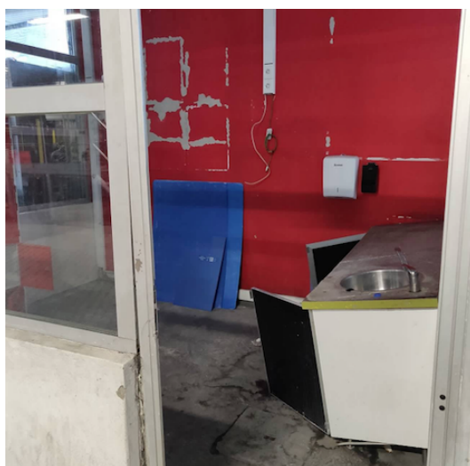
Figura 4.2: Sala de apoio das linhas de enchimento de barril em visível mau estado
