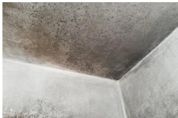
Figura 4.13 Imagem recolhida numa habitação onde se verificou humidade nas paredes do quarto
