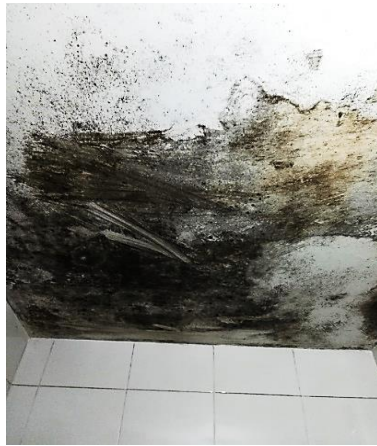
Figura 4.10 Imagem recolhida em habitações onde se verificou humidade no teto do WC
