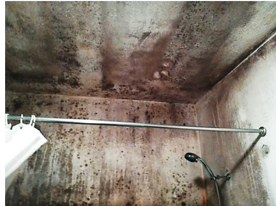
Figura 4.11 Imagem recolhida numa habitação onde se verificou humidade nas paredes e teto do WC
