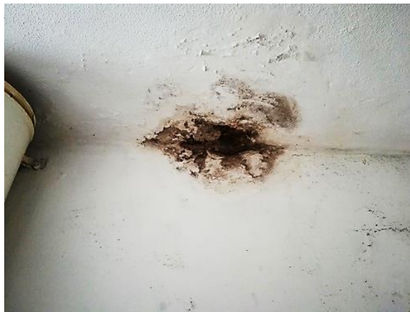
Figura 4.12 Imagem recolhida numa habitação onde existia um buraco no teto da cozinha
