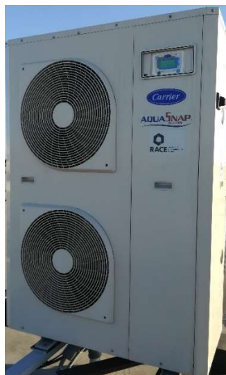
Figura B- 3 - Chiller ar-água .
