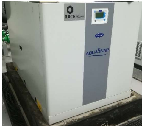
Figura B- 2 - Chiller água-água .
