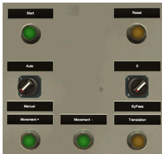
Figura 35 – Painel de controlo do quadro elétrico.
