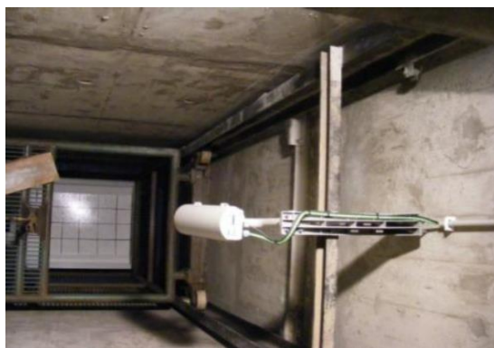
Figura B. 2 - Equipamento de vídeo-gravação digital instalado no final do trajeto da cuba do elevador do AH de Touvedo (Pádua et al., 2015)
