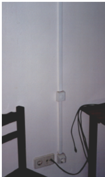
Figura 6.8: Tomada de energia controlada
