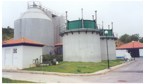
Figura 3.3 - Tratamento de lamas em digestores anaeróbios
