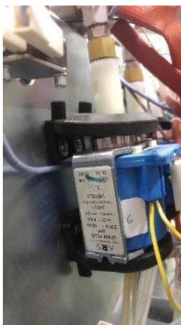
Figura 34 Bombas dos grupos (6).
