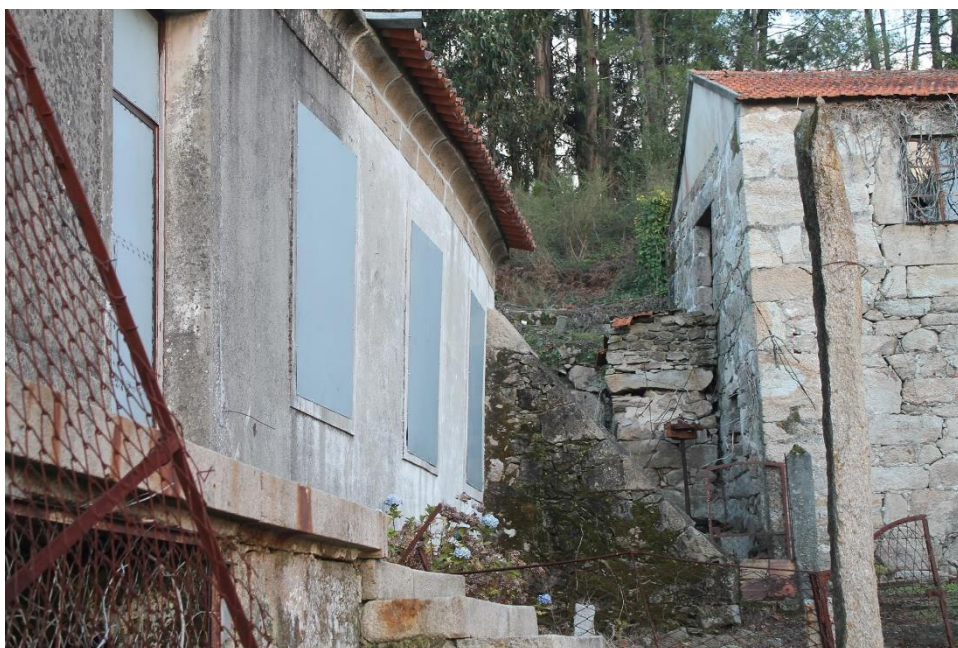
Figura 5.8 – Deformação vertical da parede exterior correspondente à sala de refeições.
