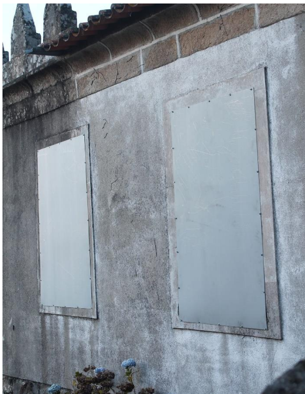
Figura 4.27 – Janelas cobertas por chapas metálicas onde já não existe caixilharia.
