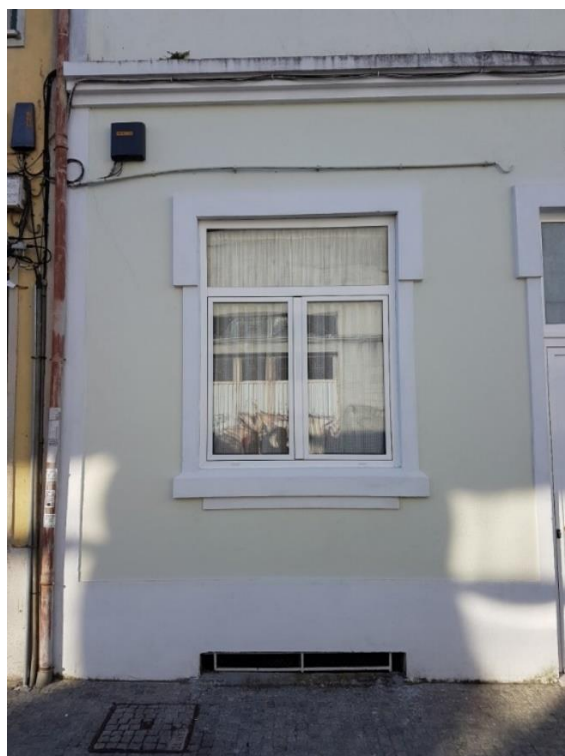
Fig.47 – Caixilharia Exterior em Alumínio
