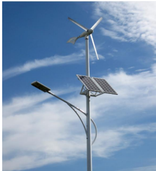
Figura 3.4: Sistema fotovoltaico híbrido real [15]
