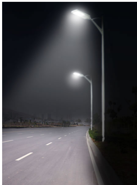
Figura 2.22: Luminárias para iluminação de auto-estrada
