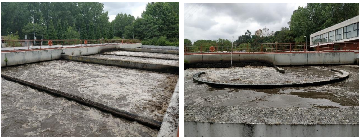
Figura 27 - Zona óxica das valas de oxidação (Fonte: Bruno Oliveira)
