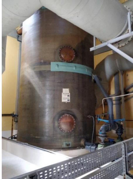
Figura 21 - Torre de desodorização (Fonte: Bruno Oliveira)
