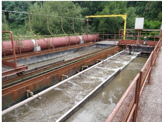
Figura 26 - Desarenador e desengordurador (Fonte: Bruno Oliveira)
