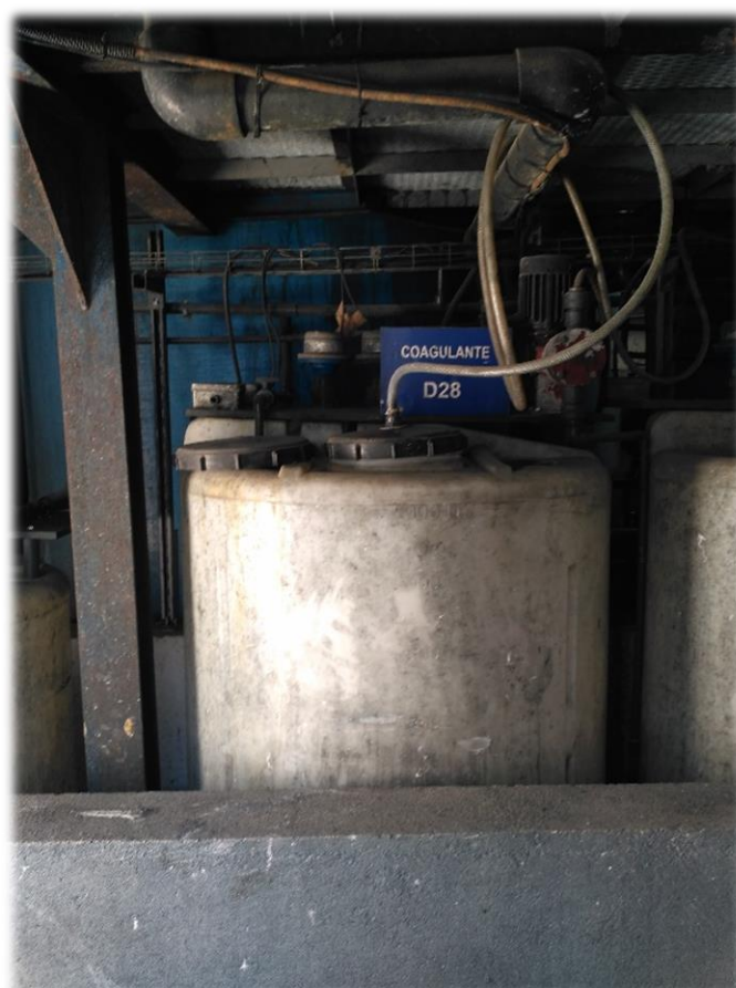
Figura 16 - Tanque de coagulante D28
