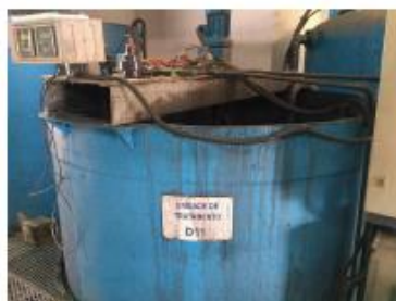
Figura 7 - Unidade de Tratamento
