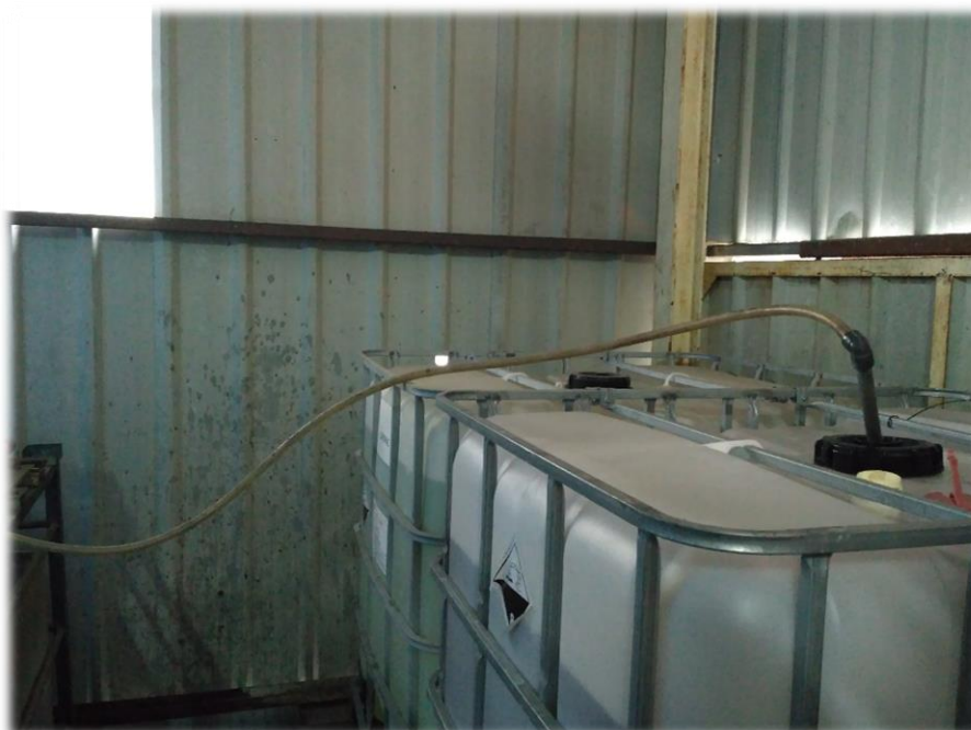
Figura 30 - Passagem do coagulante para o tanque de armazenamento
