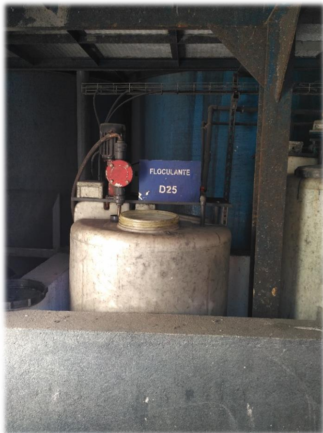
Figura 15 - Tanque de floculante D25
