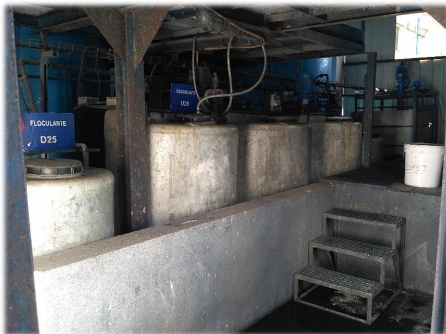
Figura 13 - Tanques de armazenamento de reagentes
