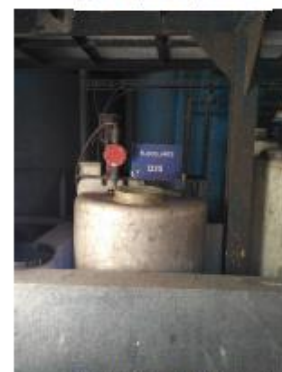
Figura 11 - Tanque de Floculante
