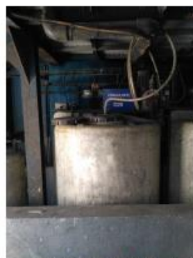
Figura 12 - Tanque de Coagulante
