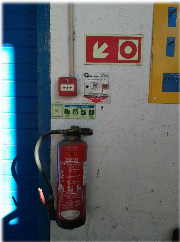
Figura 23 - Extintor e alarme contra incêndios
