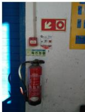
Figura 14 - Extintor e alarme de incêndio
