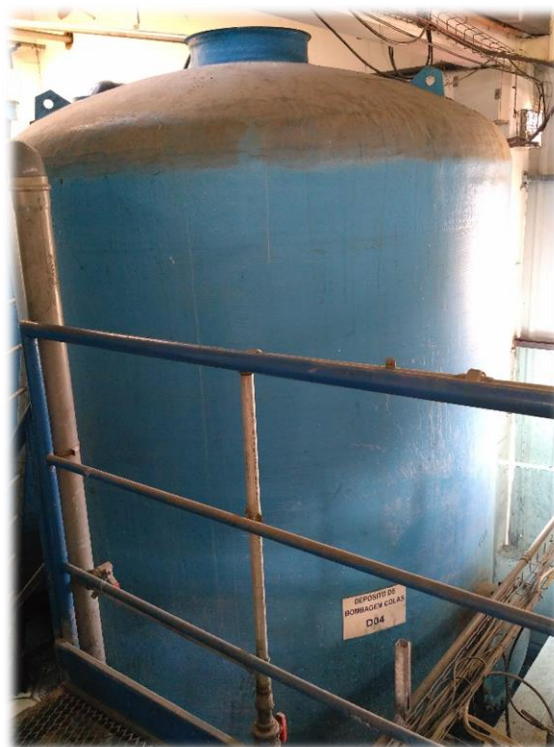
Figura 12 - Depósito de bombagem de colas D04
