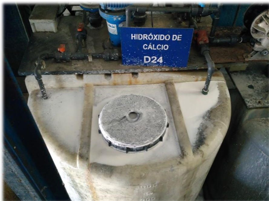
Figura 14 - Tanque de hidróxido de cálcio D24
