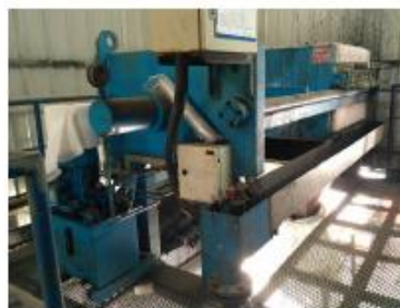
Figura 9 - Filtro de pressa
