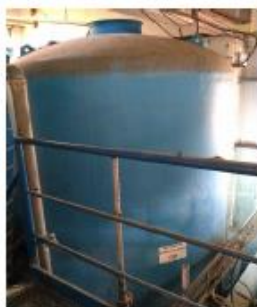
Figura 6 - Depósito de Bombagem de Colas
