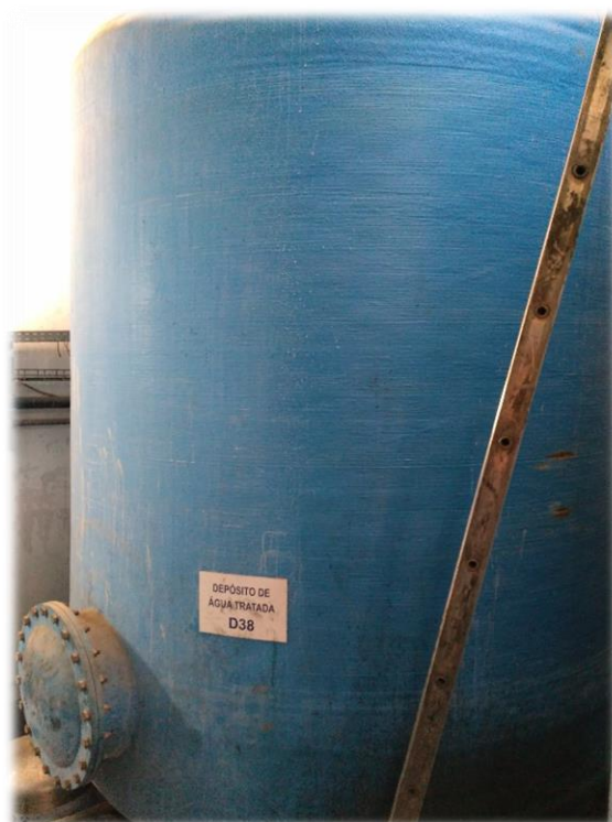
Figura 21 - Depósito de água tratada D38
