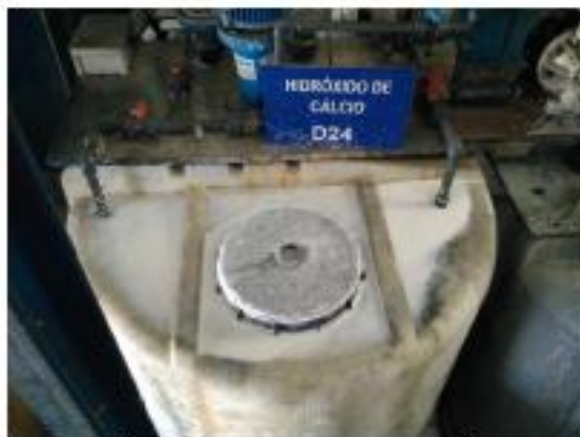
Figura 13 - Tanque de Hidróxido de Cálcio
