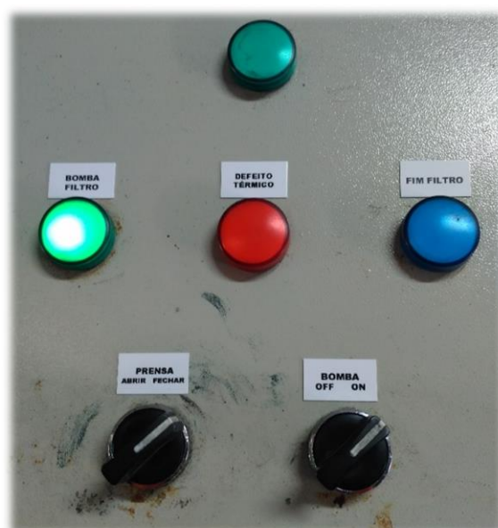
Figura 8 - Interruptores de controlo de componentes da ETARI
