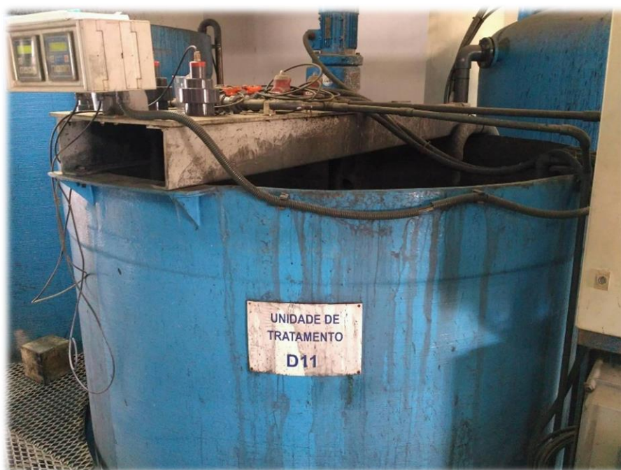
Figura 17 - Unidade de tratamento D11
