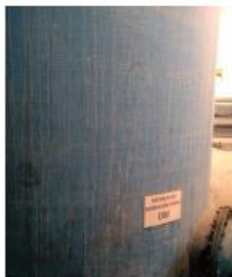
Figura 3 - Depósito de Bombagem de Tintas
