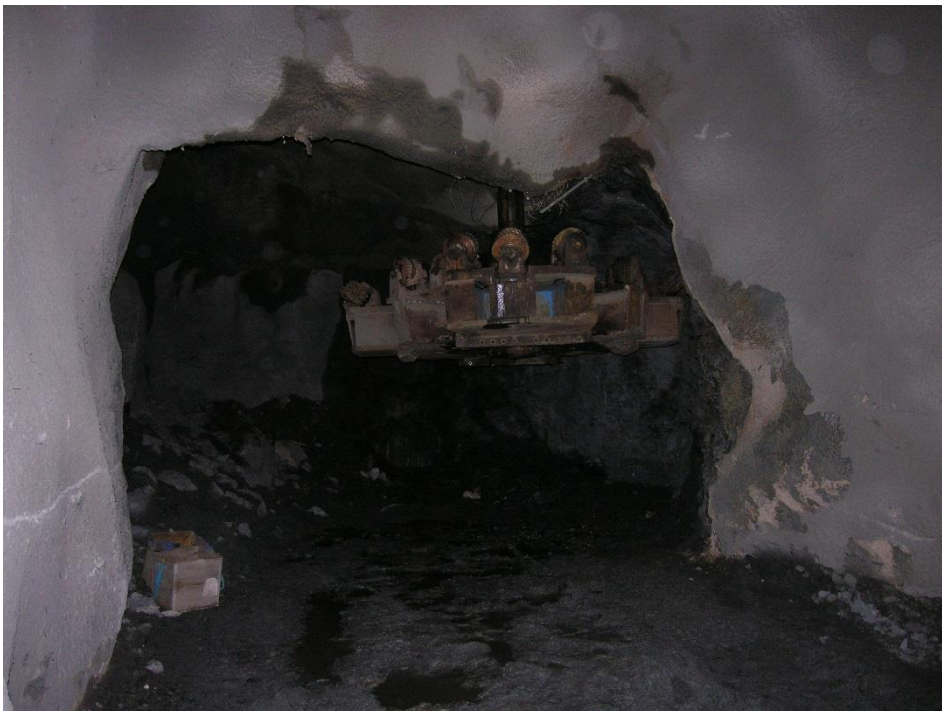
Figura 46 - Cabeça da Raise Boring acoplada
