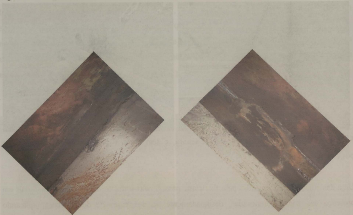
Figura 3.7 - Vistas parciais das paredes laterais internas, mostrando, mais em pormenor, os desgastes da parte superior das guias de deslizamento.
