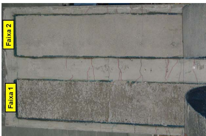
Figura 4.22 - Aspecto geral da superfície de destacamento das faixas de manta do modelo FSBM1.
