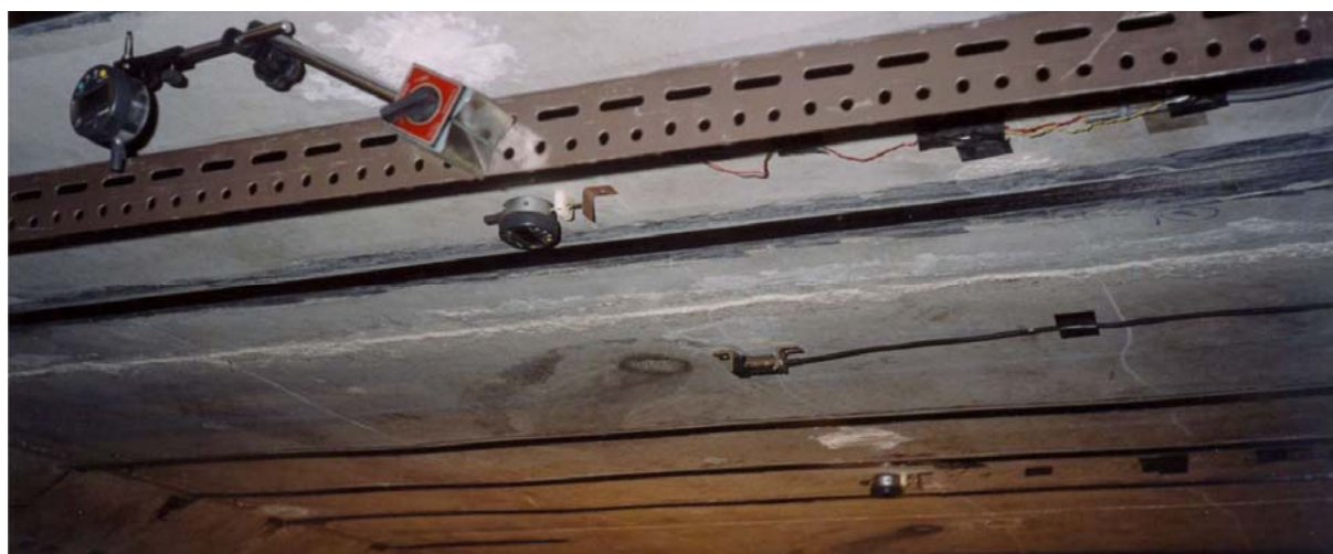
a) vista geral dos transdutores
