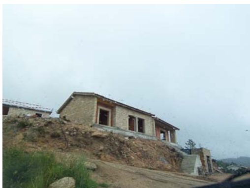
foto 20 – Destruição de afloramento rochoso, para construção de 2ª habitação
