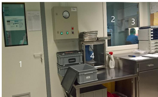
Figura 1 - Interior da UCPC de Vila Real. 1- Antecâmara; 2-Sala Limpa; 3-CFL-SB; 4-Transfer.
