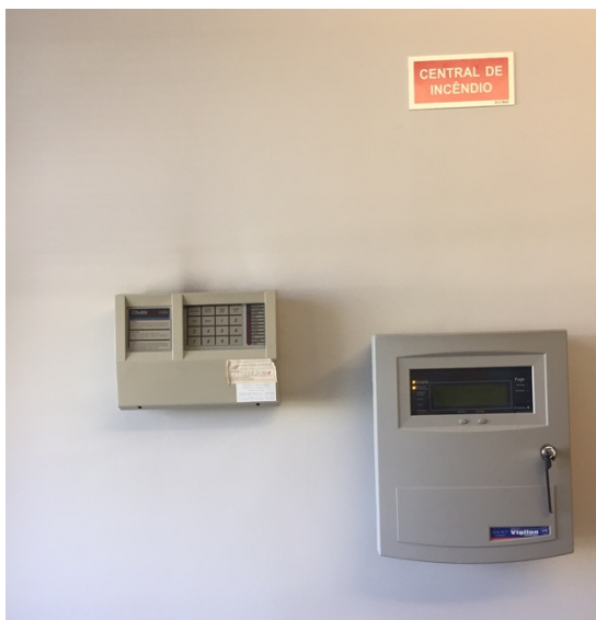
Figura 20 – Central de Incêndio e alarme de intrusão no Posto de Segurança
