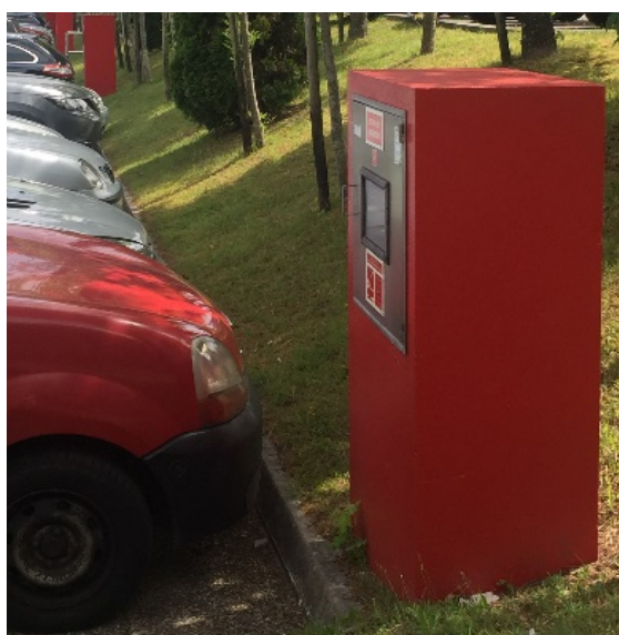
Figura 12 – Boca de Incêndio no parque de estacionamento Nascente
