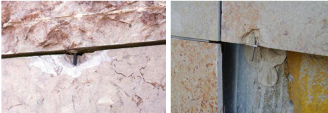
Fig. 3.2 – Quebra de placas em zonas de fixação [43]
