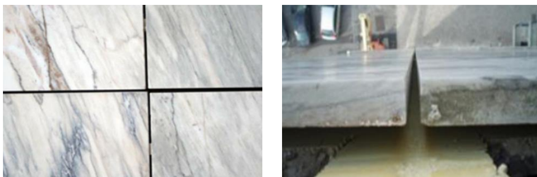
Fig. 3.10 – Desalinhamento das placas de revestimento [43]
