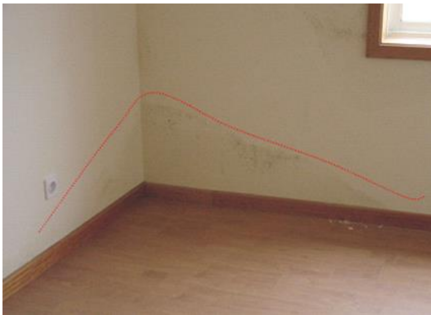
Fig. 3.14 – Humidade interior causada por infiltrações na caixa-de-ar
