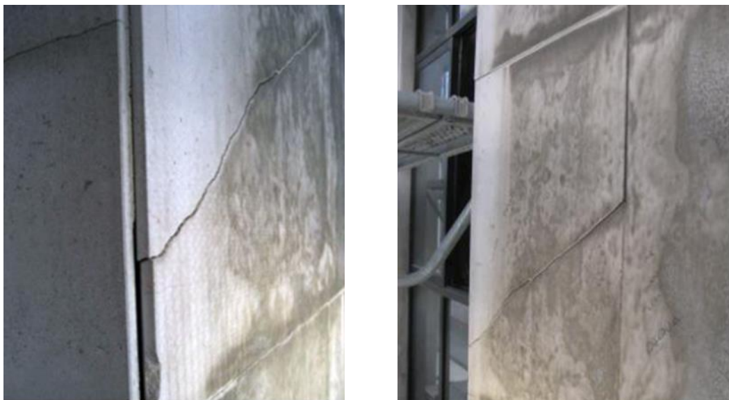
Fig. 3.11 – Quebra de placas em zona não acessível [43]
