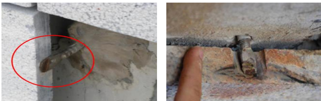
Fig. 3.12 – Corrosão dos fixadores [43]
