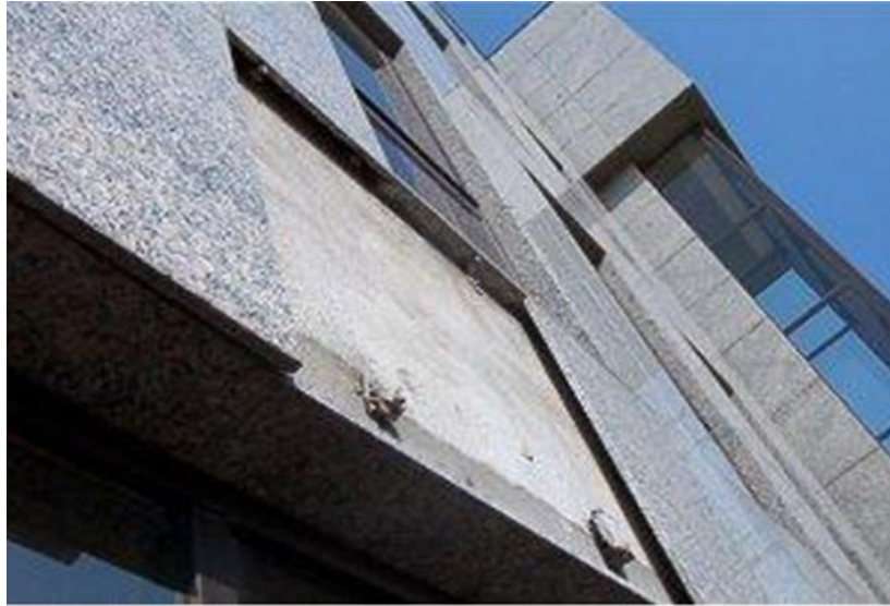
Fig. 3.5 – Desprendimento da placa de revestimento [41]
