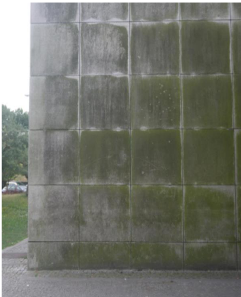
Fig. 3.4 - Musgos, manchas de sujidade e de eflorescência na superfície de um revestimento de granito
