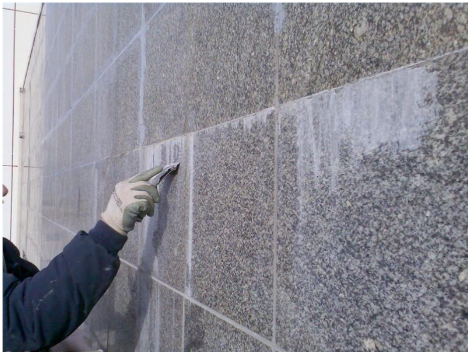
Fig. 3.3 – Eflorescências em fachada [45]
