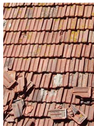
Anomalias em telhas cerâmicas, com fungos e material partido em pequena extensão
