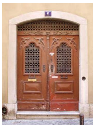
Anomalia em porta de madeira exterior com pequena extensão
