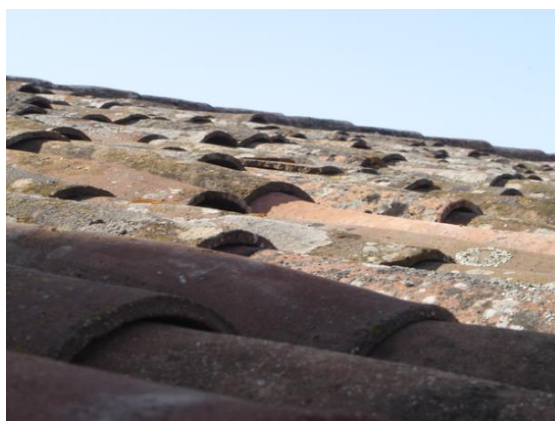
Anomalias em telhas cerâmicas, com a presença de fungos e pátina com extensão média
