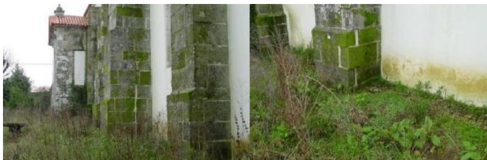
Fig. 3.6 – Paredes exteriores marcadas com manchas e musgos, especialmente em toda a altura dos contrafortes [2]
