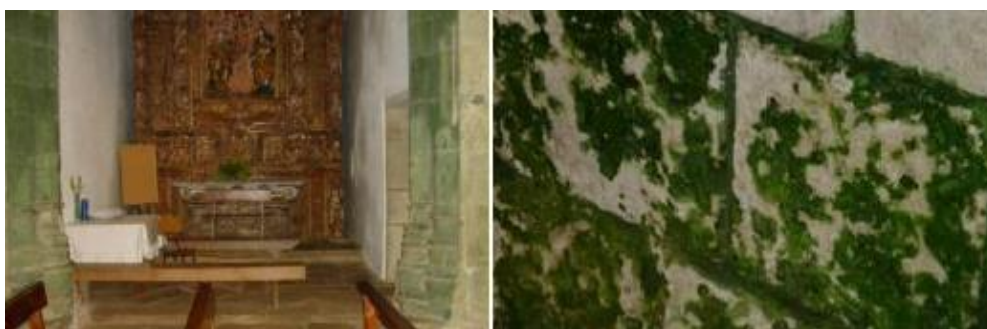
Fig. 3.5 – Paredes interiores com vestígios de humidade [2]
