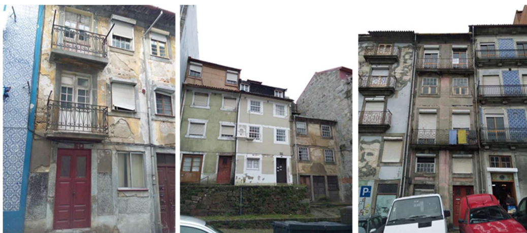
Fig. 4.6 – Fotos exemplo de edifícios da zona em análise, considerados pelo autor como estado de conservação “MAU”.
