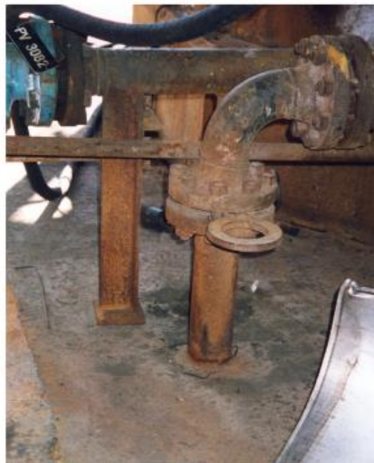
Figura 4: Exemplo de corrosão de uma tubagem à superfície.
