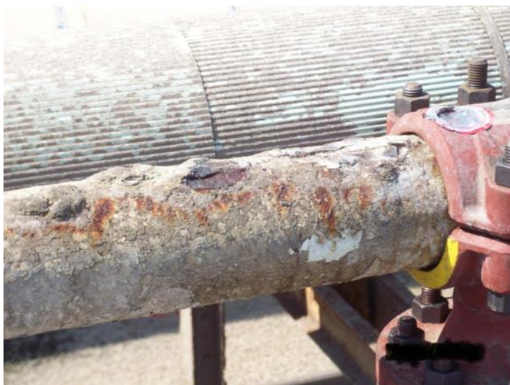
Figura 1: Corrosão atmosférica severa de uma tubagem de gás próxima de uma torre de água.
