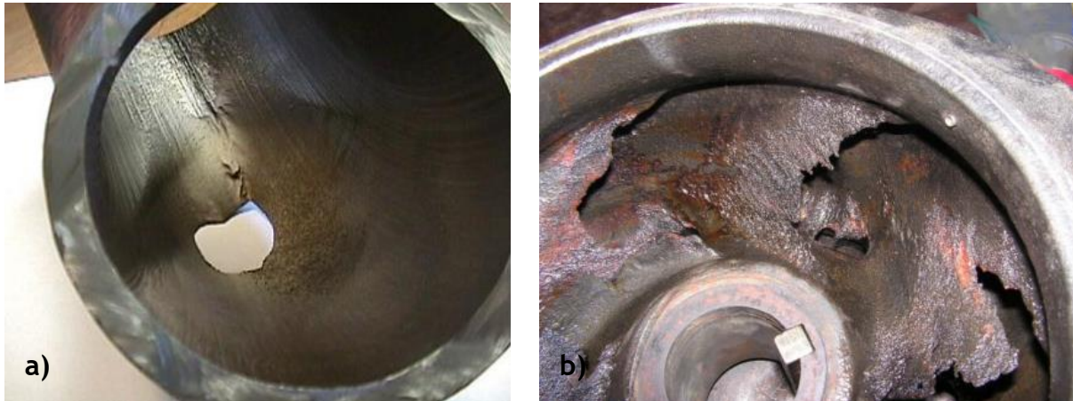
Figura 3: Na imagem (a) perda de espessura até abertura de um furo, na imagem (b) deterioração de uma turbina.
