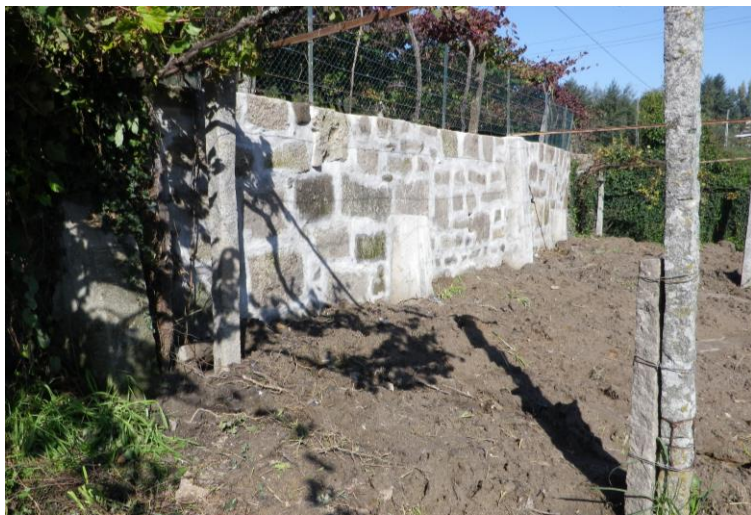
Fotografia 5 – Muro oeste da Quinta, junto do cunhal de junção ao muro norte. É visível a reconstrução do muro, depois da sua queda por elevada impregnação de água no terreno em que assenta.
