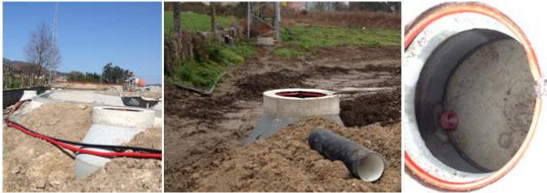
Figura 4.43 - Caixas de visita rede média tensão
