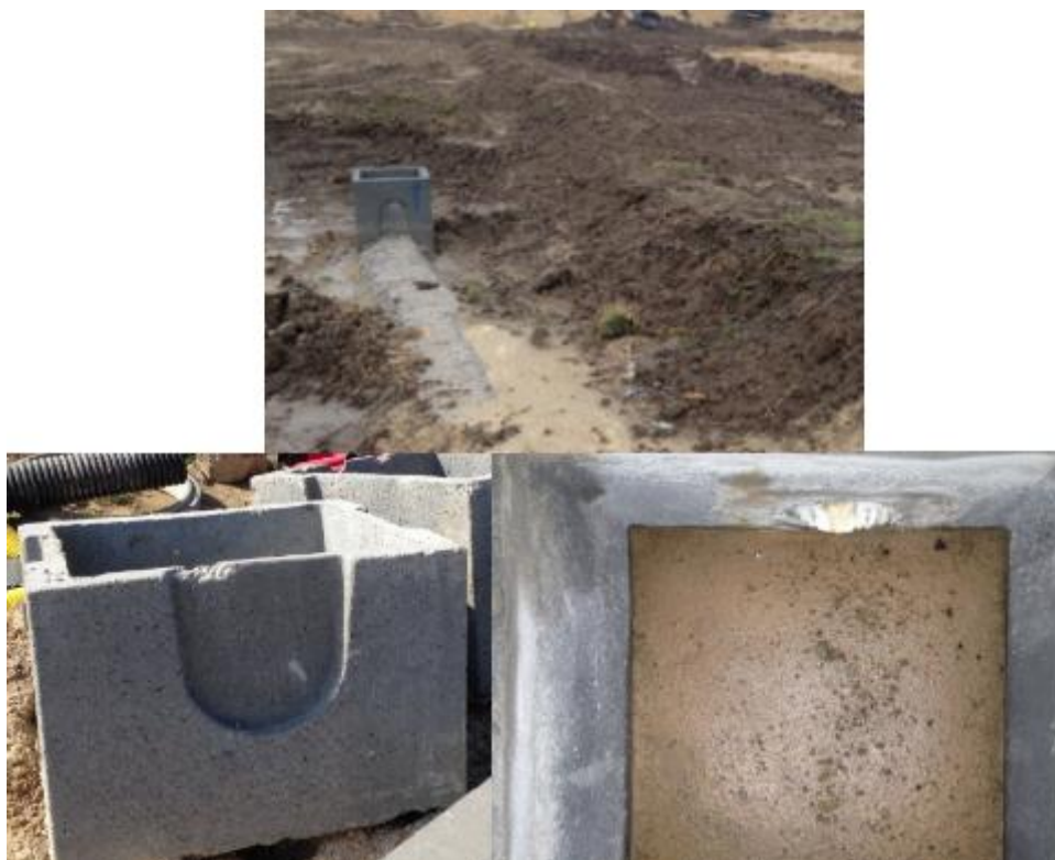
Figura 4.24 - Pormenores das caixas de areia executadas
