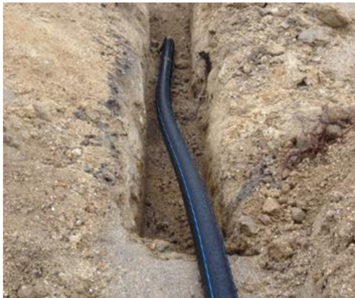
Figura 4.31 - Tubagem de abastecimento de água em PVC
