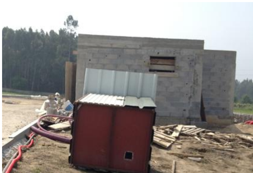
Figura 4.42 - Casa das máquinas
