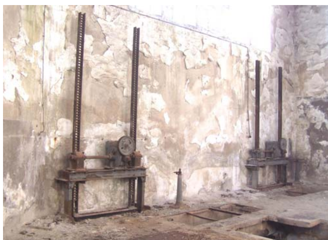
Fig. 5. Foto actual do interior da Casa das Bombas. Encontra-se no local o sistema de comportas que permite a entrada das águas no poço de reserva.
